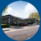
PV-Überdachung von Parkplätzen in NÖ
